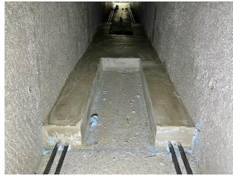
Abb. 11: Teilweise im nachträglichen Verbund liegende Vorspannung
